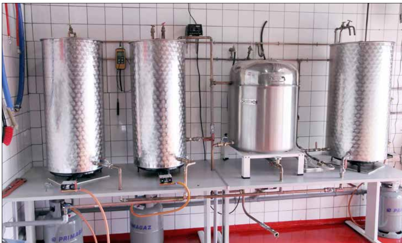
De nieuwe installatie van Stadsbrouwerij De Kromme Jat
